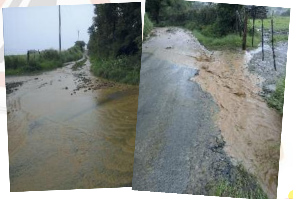
Inondation route de Randant et Charpenet
